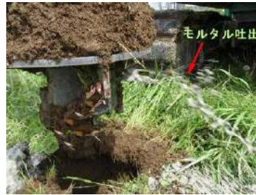
モルタル突出状況確認
